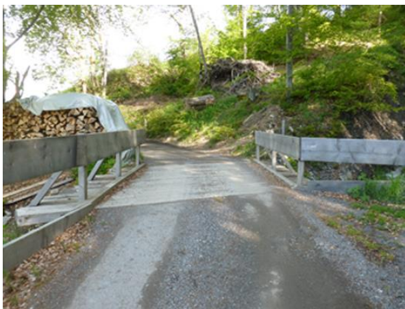
Abbildung 14: Strasse 4 Asphaltdecke bis zur Brücke vor Pardälija.
