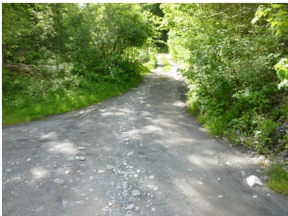
Abbildung 18: Strasse 6.2 kaum vorhandener Betonbelag.
