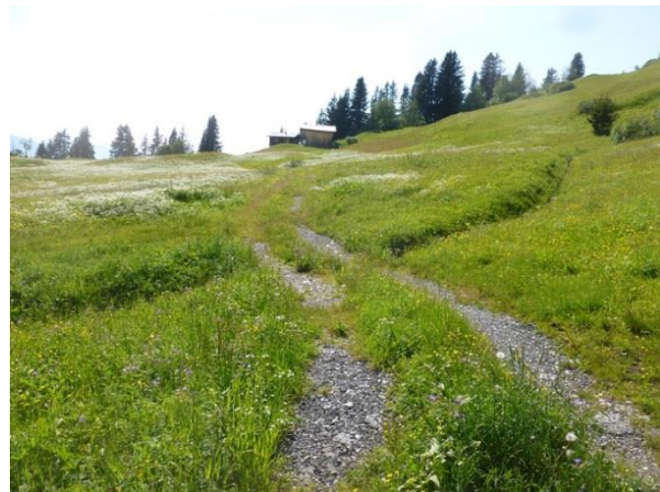
Abbildung 25: Strasse 22, verwachsene Fahrbahn und fehlende Verschleisschicht.
