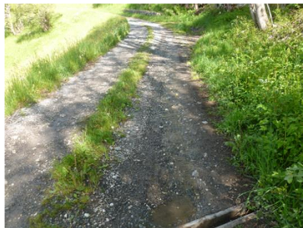
Abbildung 15: Strasse 4 stark beschädigte Kiesfahrbahn.
