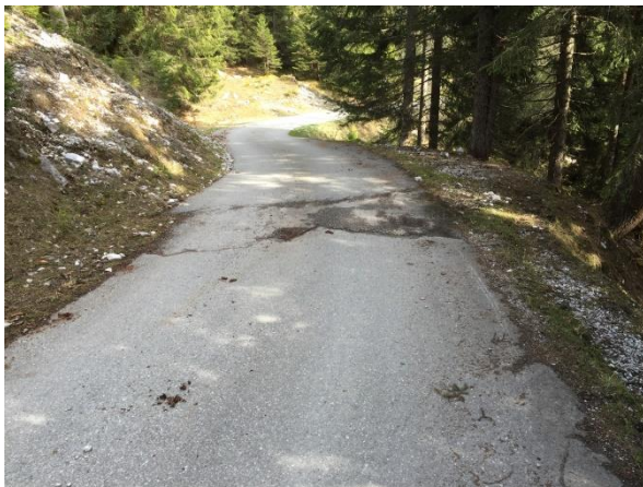
Abbildung 10: Asphaltstrasse mit Schäden in der Verschleisschicht.
