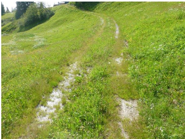
Abbildung 24: Strasse 22, verwachsene Fahrbahn und fehlende Verschleisschicht.
