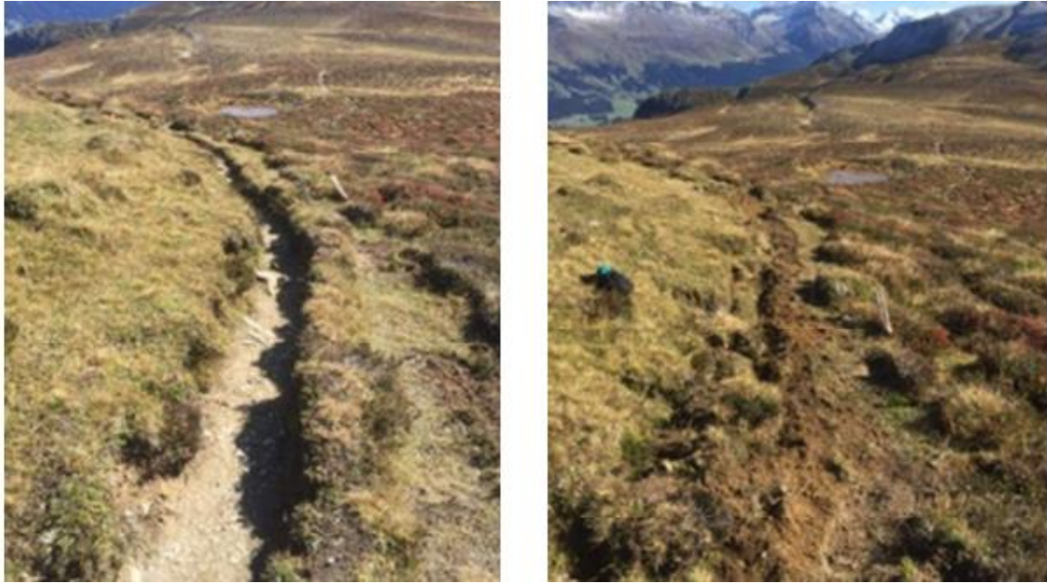
Abbildung 13: Vorher/Nachher Bilder eines tief in den Boden erodierten Weg. Die Talseitige Vegetation wurde abgetragen und bergseitig wieder eingesetzt. Somit kann der Weg wieder oberflächlich entwässert werden. (Bilder: Wegunterhalt Gemeinde Churwalden, ALLEGRA in Zusammenarbeit mit Werkhof)
